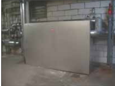
Fernwärmeübergabestation der Stadtwerke Waiblingen Anschlussleistung 900 kW
