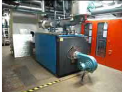
Ölkessel (Redundanz) Hersteller: Buderus Nennwärmeleistung: 850 kW
